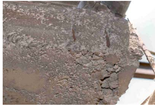
شکل ۴ - نمونه ای از بتن ریزی نامطلوب
