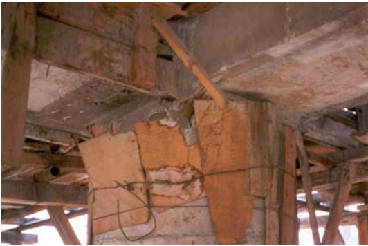
شکل ۵ - نمونه ای از قالب بندی نامناسب گره
