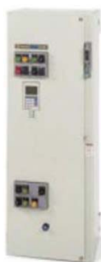
شکل ۱-۹۱- کنترل پانل (نصب شده بر روی کف)
