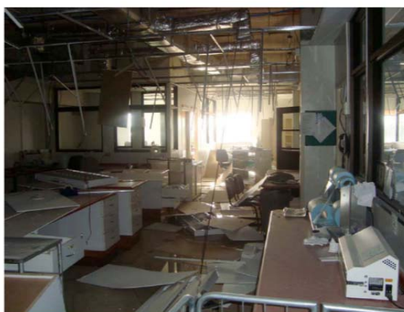
شکل پ ۲-۹- خرابی کلی شبکه سقف، بلوک‌های گچی سقف کاذب، چراغ‌ها و دیفیوزرها در بیمارستانی با نام لوس انجلس در
