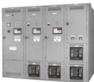
شکل ۱-۸۸- سوئیچ انتقال و ورودی سرویس (نصب شده بر روی کف)
