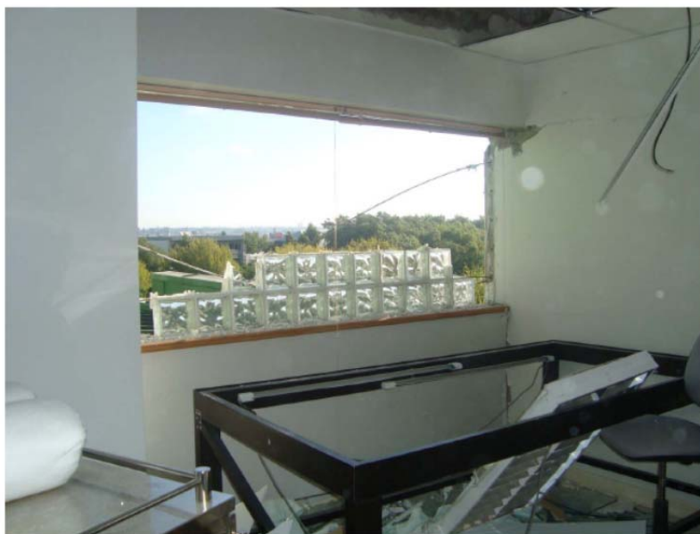
شکل پ ۲-۲- آسیب وارده به پانل‌های شیشه‌ای در بیمارستان در زلزله ۲۰۱۰ شیلی
