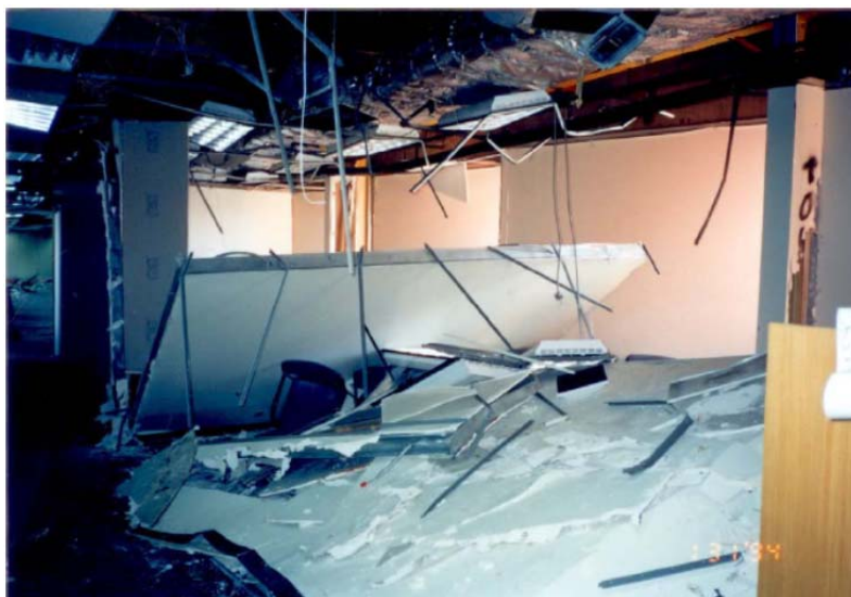
شکل پ ۲-۸- خرابی مهارهای نامناسب پارتیشن نیمه ارتفاع فلزی در زلزله ۱۹۹۴ نورث ریج
