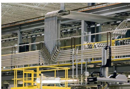
شکل ۱-۸۳- لوله تحت فشار
