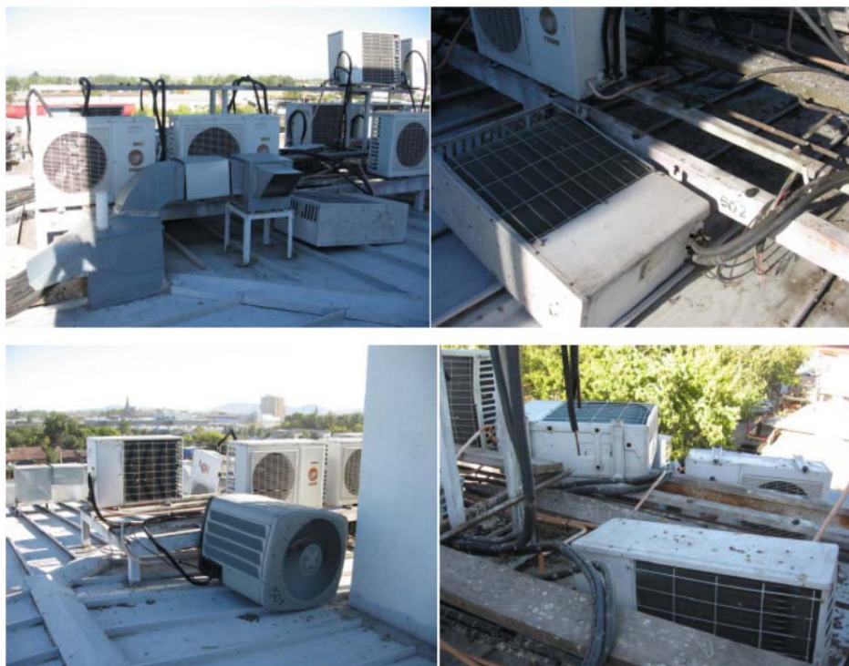
شکل پ ۲-۱۳- افتادن و خرابی تعداد زیادی از تجهیزات واقع بر سقف به علت مهار نامناسب در زلزله ۲۰۱۰ شیلی
