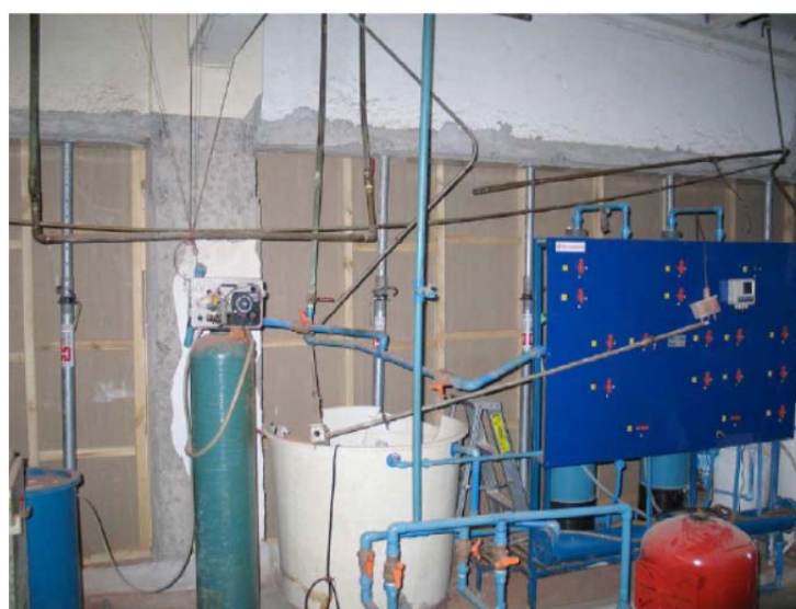
شکل پ ۲-۷- خرابی دیوار میان قابی آجری و افتادن آن بر روی دو مخزن آب ۶۰۰ لیتری آب شد که باعث ورود آب به ۳ تا ۶ اطاق عمل بیمارستان واقع در شیلی شد و از مدار خارج شدن آنها گردید (زلزله ۲۰۱۰ شیلی)
