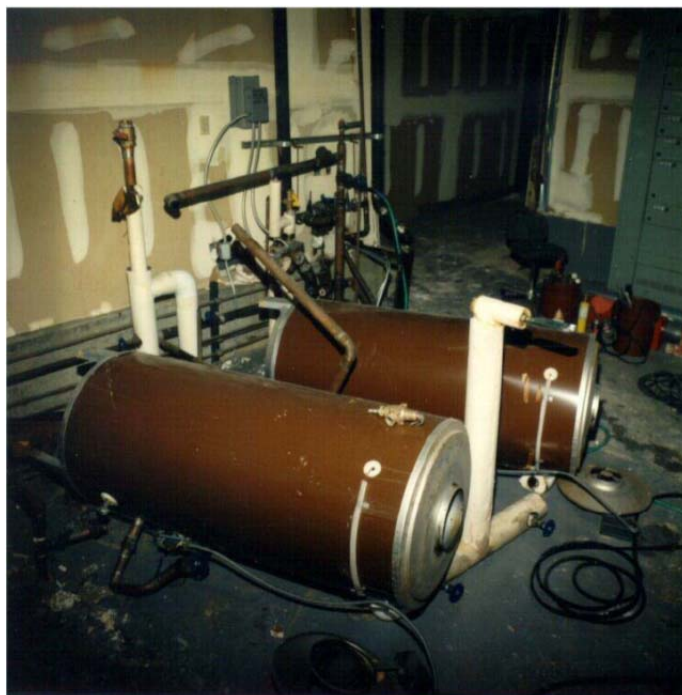
شکل پ ۲-۱۸- واژگونی آبگرمکن مهار نشده بر اثر زلزله
