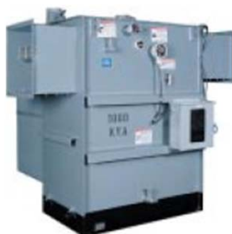
شکل ۱-۱۳۲- مبدل پر شده با مایع ایستگاه فرعی انتقال برق
