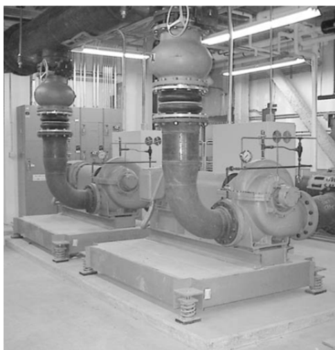
شکل ۵-۱۵۸- نمونه استفاده از اتصال شکل پذیر در محل اتصال لوله به پمپ
