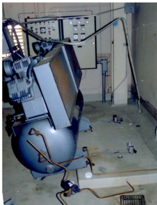
شکل پ ۲-۱۲- خرابی کمپرسور متصل به کف به وسیله جداساز ارتعاش کف نامناسب در زلزله ۱۹۹۴ نورث ریج
