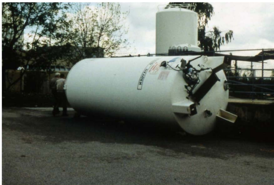
شکل پ ۲-۱۶- خرابی و افتادن مخزن قائم در بیمارستان بر اثر مهار ناکافی در اثر زلزله ۱۹۹۴ نورث ریج
