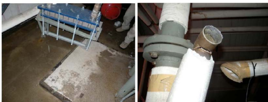
شکل پ ۲-۲۰- خرابی لوله مسی آب گرم بیمارستان san carlos در زلزله ۲۰۱۰ شیلی این خرابی بر اثر جابجایی بویلری که به نحو مناسبی مهار نشده بوده است اتفاق افتاده است.
