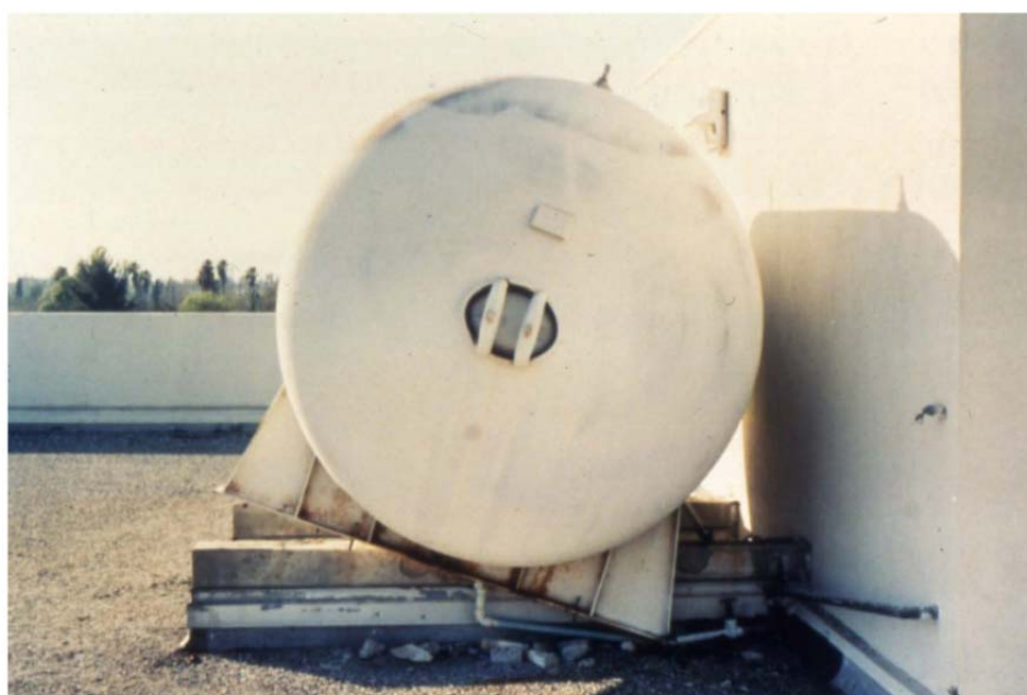
شکل پ ۲-۱۵- جابجایی و خارج شدن مخزن واقع بر روی بام بیمارستان گراناادا هیل در زلزله نورث ریج که باعث از مدار خارج شدن مخزن و خرابی لوله‌های منتهی به آن شده است.
