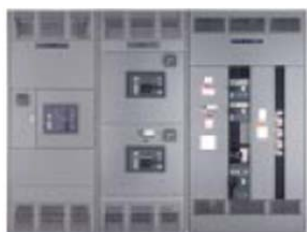
شکل ۱-۱۱۰- تابلو برق ولتاژ پایین (نصب شده بر روی کف)
