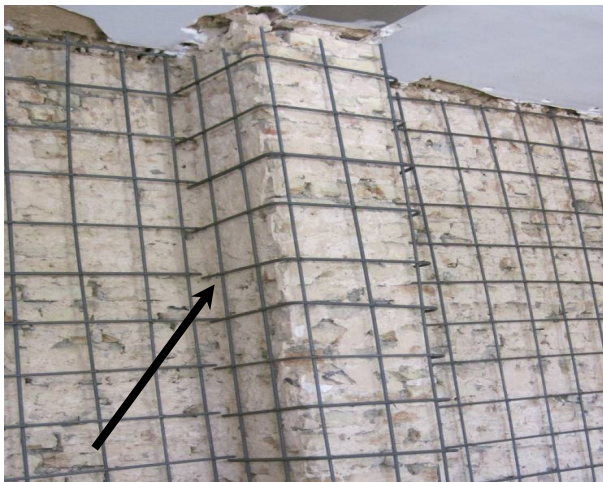
شکل ۲۸: نمایی از عدم اتصال شبکه میلگرد در کنجها
