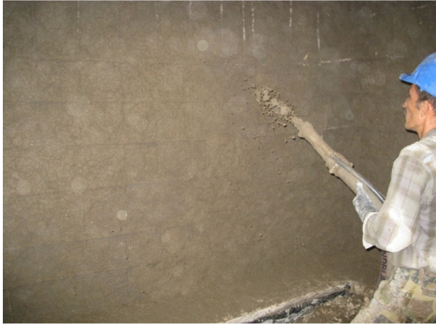
شکل ۳۲: نمایی از استفاده از بتن با کیفیت پایین و همچنین عمود نبودن نازل روی سطح بتن پاشی
