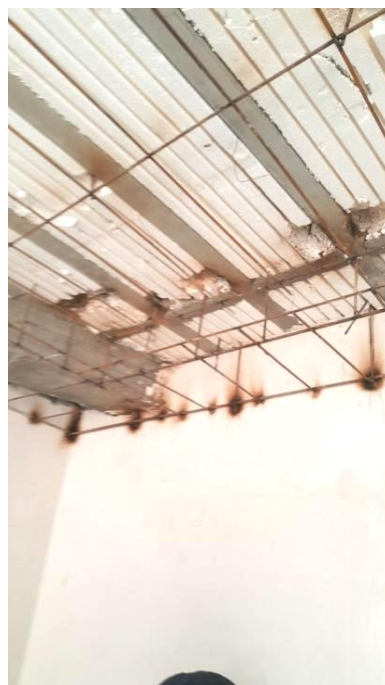
شکل ۱۸- ساپورت گیری نامناسب از تیرچه و تخریب آنها شکل ۱۹- عدم اجرای درب دودبند و مقاوم حریق (استفاده از درب شیشه ای بدون تاییدیه معتبر و مغایر نقشه های مصوب)
