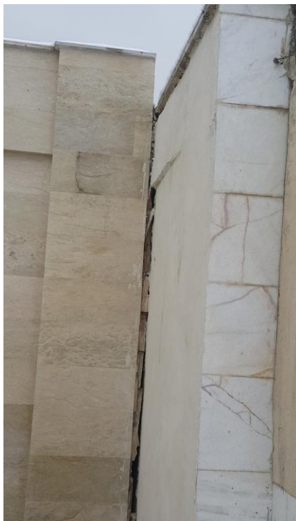
شکل ۱۶- عدم پوشش مناسب درز انقطاع و چسبیدن آن به ساختمان مجاور بوسیله مصالح سنگی نما و پرکردن این فاصله با خرده سفال
