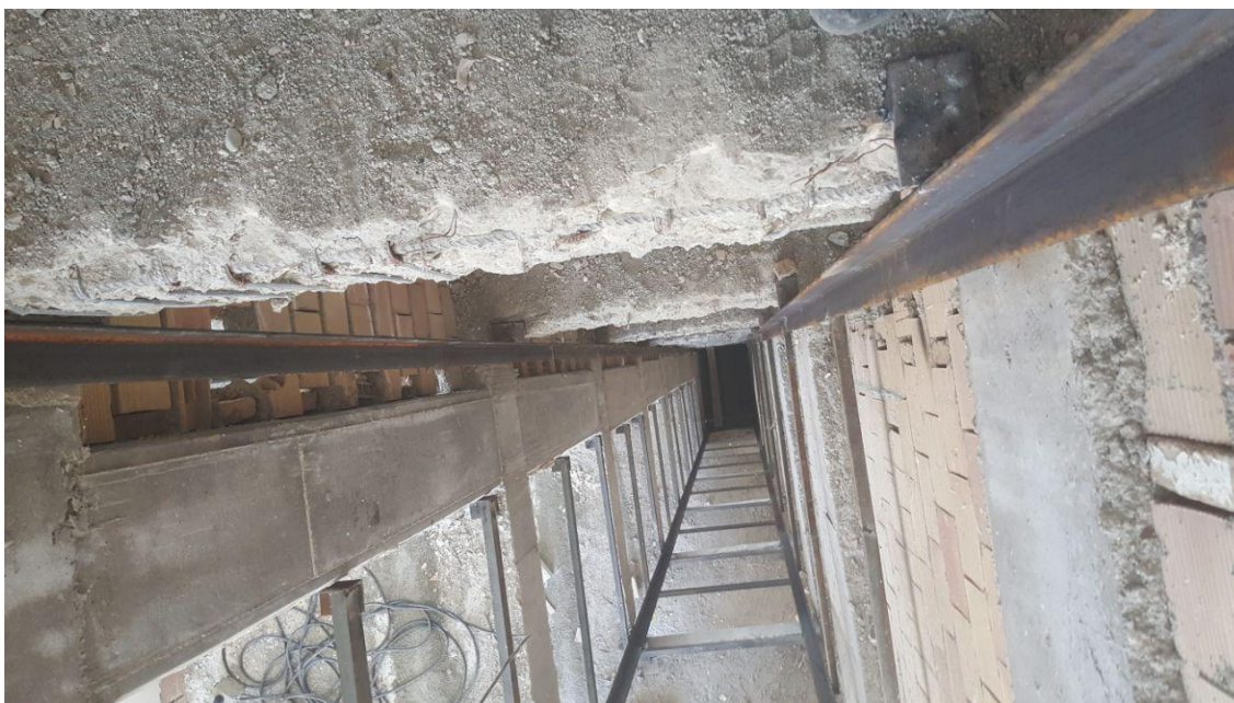
شکل ۱- تخریب پوتر برای نصب آسانسور به علت عدم دقت در جانمایی و کنترل ابعاد چاله آسانسور
