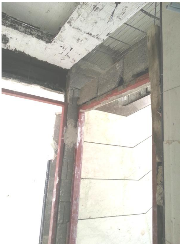
شکل ۱۰- عدم اجرای نعل درگاه یا کمرکش برای درب های داخلی ساختمان مغایر با نقشه های مصوب
