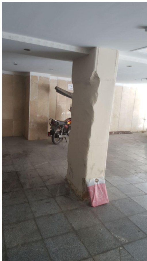
شکل ۲- تخریب ستون برای تامین دهانه پارکینگ، به علت عدم دقت در اجرای ستون ها یا عدم احتساب نازککاری در حین اجرا.
