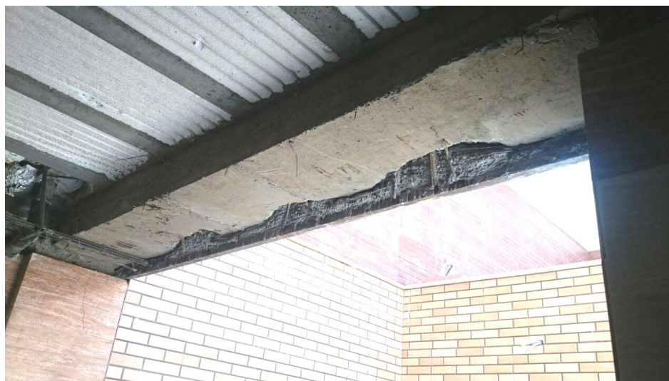
شکل ۸- اجرای نبشی کشی جهت اجرای سازه نگهدارنده نما و عدم توجه به آن در مرحله اسکلت و سقف که موجب تخریب تیر اصلی شده است
